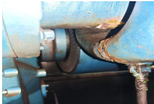
Gambar 1. Kondisi lubang drainase dan area roda gigi Pompa Air Bersih (Sumber: dokumentasi lapangan, 2025).
